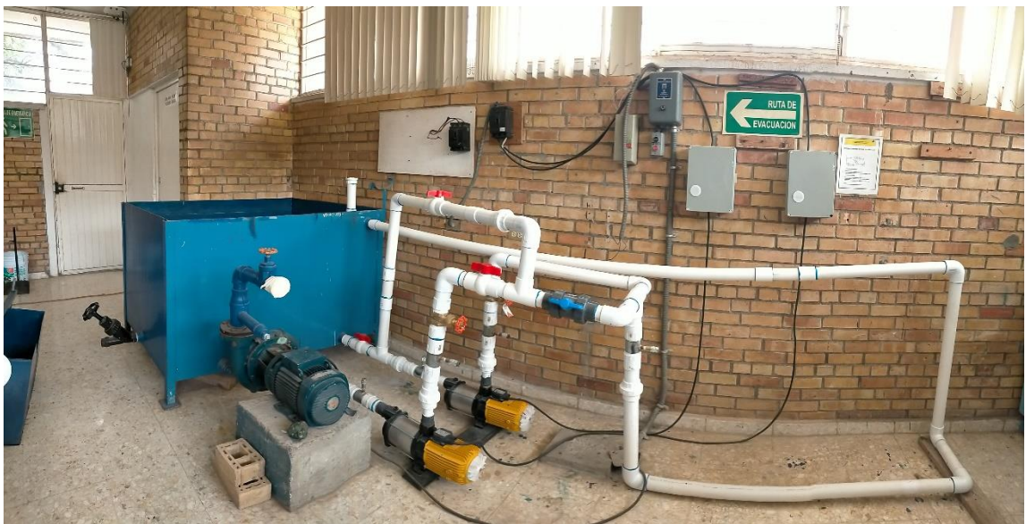
Figura 20.- Sistema de conducción
