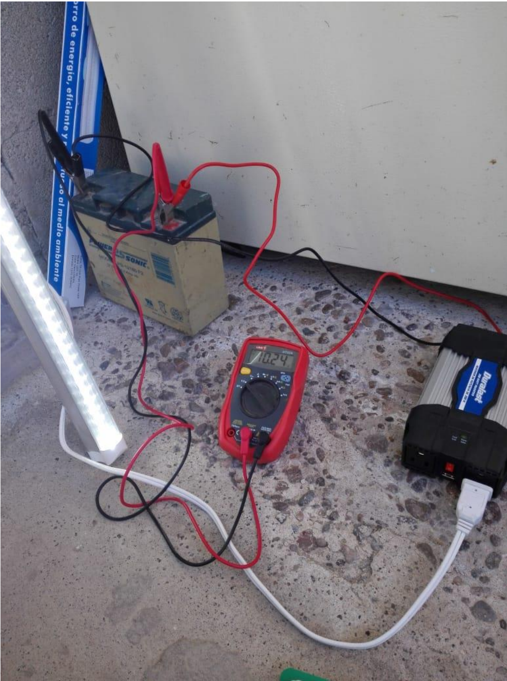
Figura 15. Fotografía de sistema funcionando
