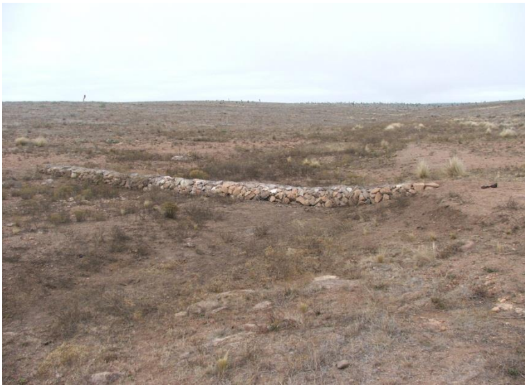
Figura 33. Detalle de las obras de control de cárcavas realizadas dentro del APFF Maderas del Carmen en el Ejido Los Lirios.
