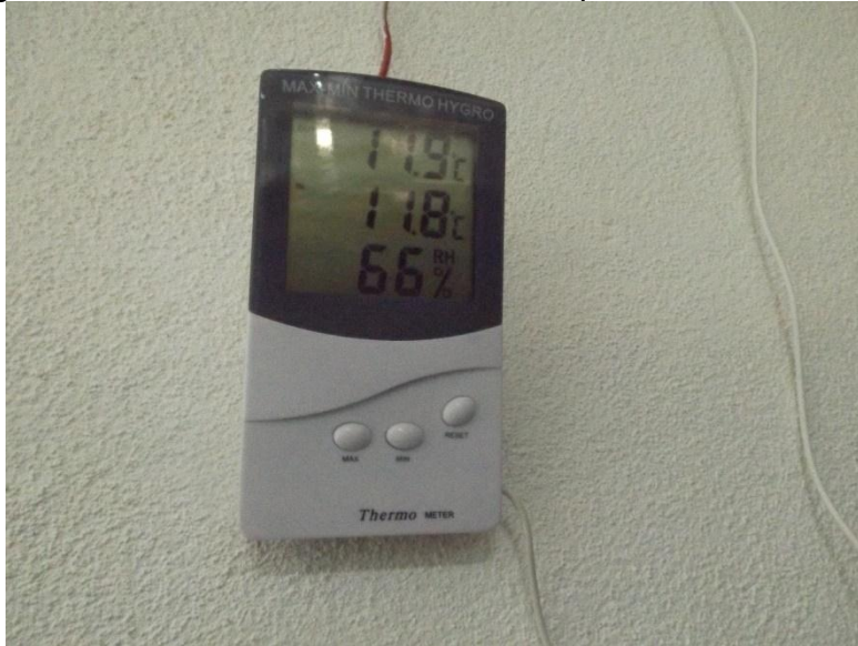
Figura 13. Termómetro Control de Temperaturas Cuarto Frio
