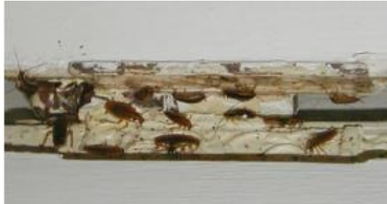
Figura 25. B. germanica en grieta (puerta de madera) (Alonso, 2009).
