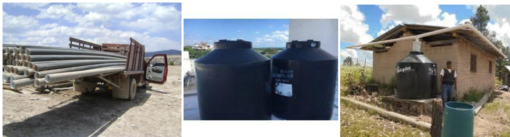
Figura 26.- Instalación de cosechas para agua de lluvia.
