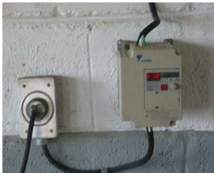
Figura 3.7. Variador de frecuencia
