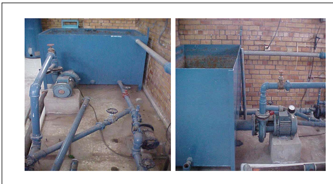
Figura 3.10. Bombas y válvulas utilizadas para controlar los diferentes gastos que se hicieron circular, por las diferentes tuberías y diafragmas.
