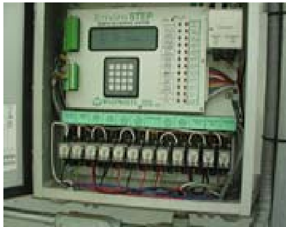
Fig.(3.5.13). Controlador Central que opera todos los equipos [Cortinas, ventilas, calefactor, pantalla térmica, nebulización y riego] en forma automática, con base en parámetros que le dan, para el día, para la noche y para el periodo DIF. Enciende alarmas cuando se rebasan límites especificados.
