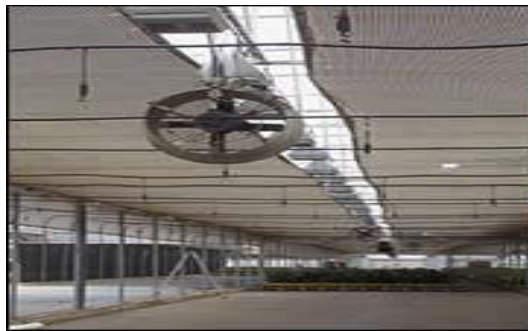
Fig.(3.5.8).Equipo de Ventilación.
